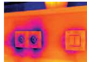
Обнаружение утечек тепла и визуализация тепловых потерь
